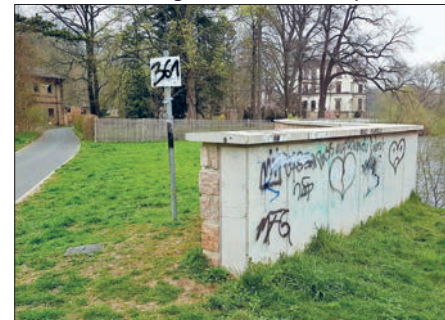
Beschädigung durch Graffiti an der Hochwasserschutzmauer Villa Gückelsberg Foto: Landestalsperrenverwaltung Sachsen
